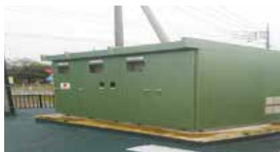
配電設備遮熱
