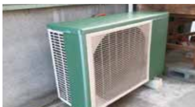
空調機室外機遮熱
