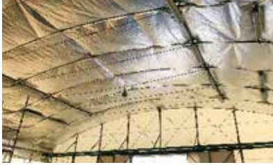
倉庫テント遮熱
